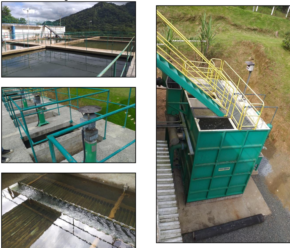
Figura 3.11 - Unidades de Tratamento da ETA Bracinho.
