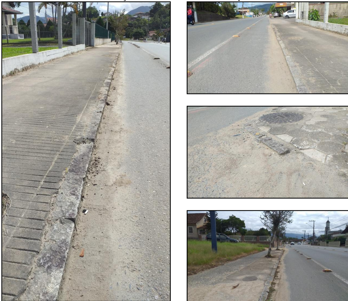
Figura 3.53 – Falta de manutenção dos dispositivos de microdrenagem por serviços de varrição na área urbana do município.
