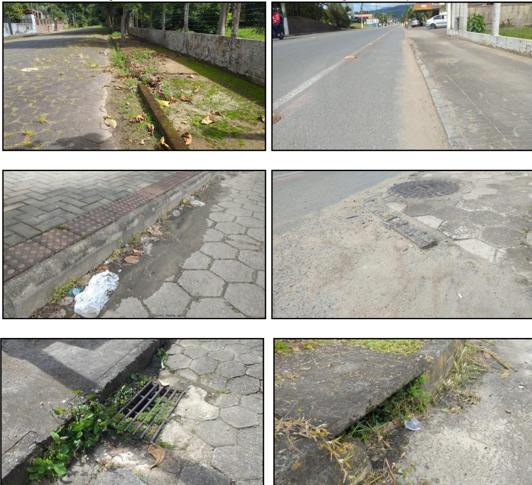
Figura 3.45 - Vias públicas na área urbana do município de Schroeder com aspectos de conservação relacionados com a falta de serviços de limpeza urbana.
