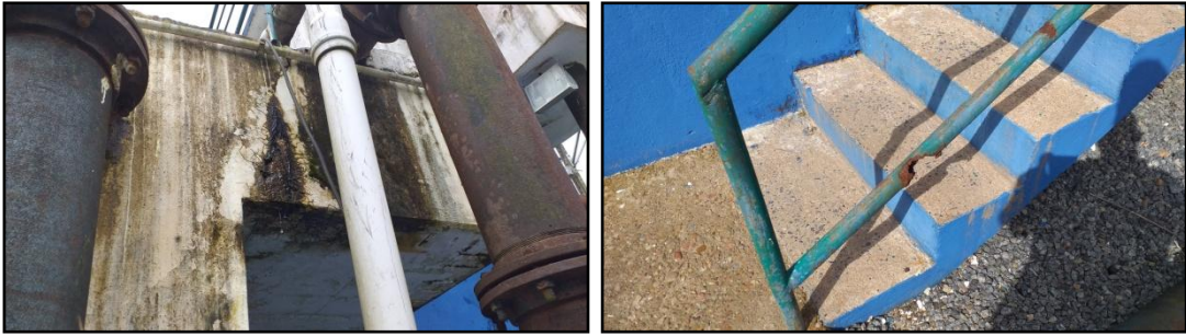
Figura 3.17 - Unidades estruturais da ETA com necessidade de manutenção e reformas.
