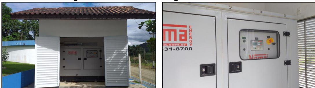
Figura 3.15 - Gerador de energia da ETA Bracinho.
