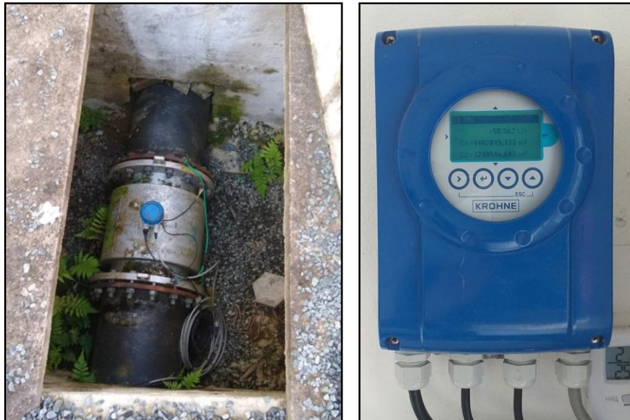
Figura 3.20 - Macromedidor e sistemas monitoramento da vazão e do nível de água dos Reservatórios R2 e R3.
