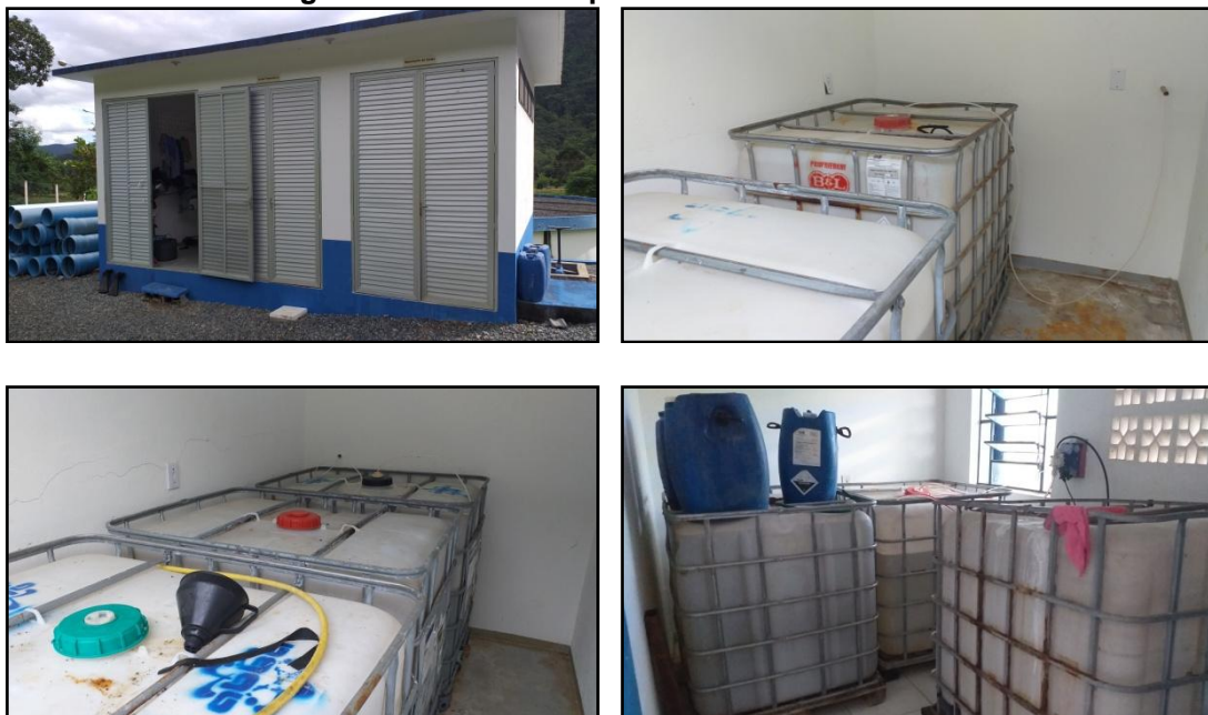
Figura 3.13 - Casa de química da ETA Bracinho.
