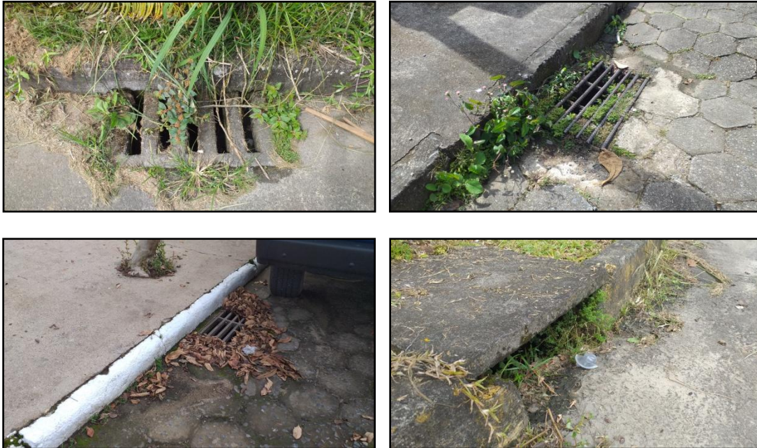
Figura 3.54 – Falta de manutenção dos dispositivos de microdrenagem por serviços de limpeza de bocas-de-lobo na área urbana do município.
