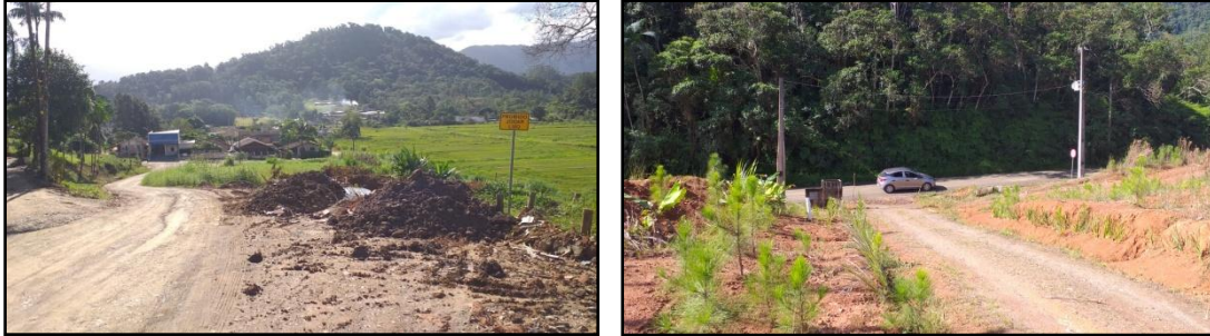
Figura 3.52 – Ruas sem pavimentação na área urbana do município.
