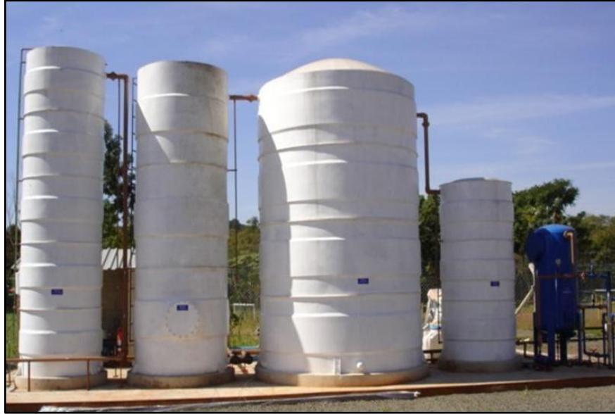
Figura 3.31 - Estação Compacta de Tratamento de Esgotos Sanitários.
