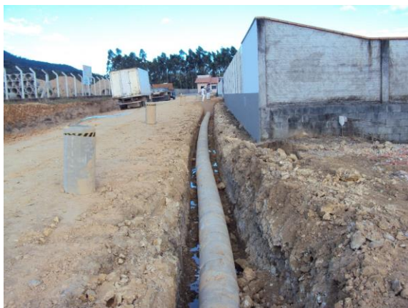
Tubulação REJEITADA (sinuosidade e falta de rejunte)
