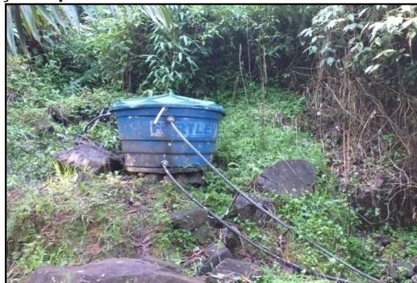
Figura 3.9. Captação superficial realizada em área rural da localidade Duas Mamas.
