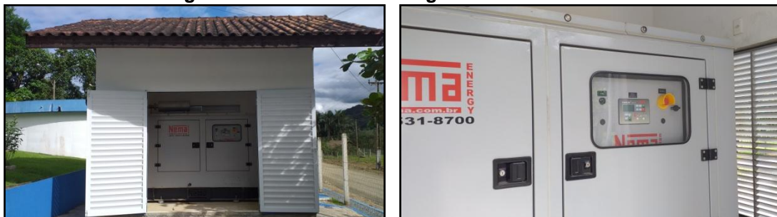
Figura 3.15. Gerador de energia da ETA Bracinho.
