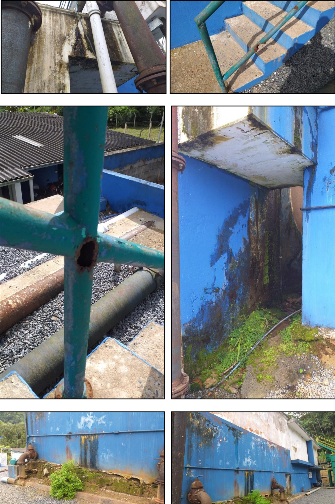
Figura 3.17. Unidades estruturais da ETA com necessidade de manutenção e reformas.
