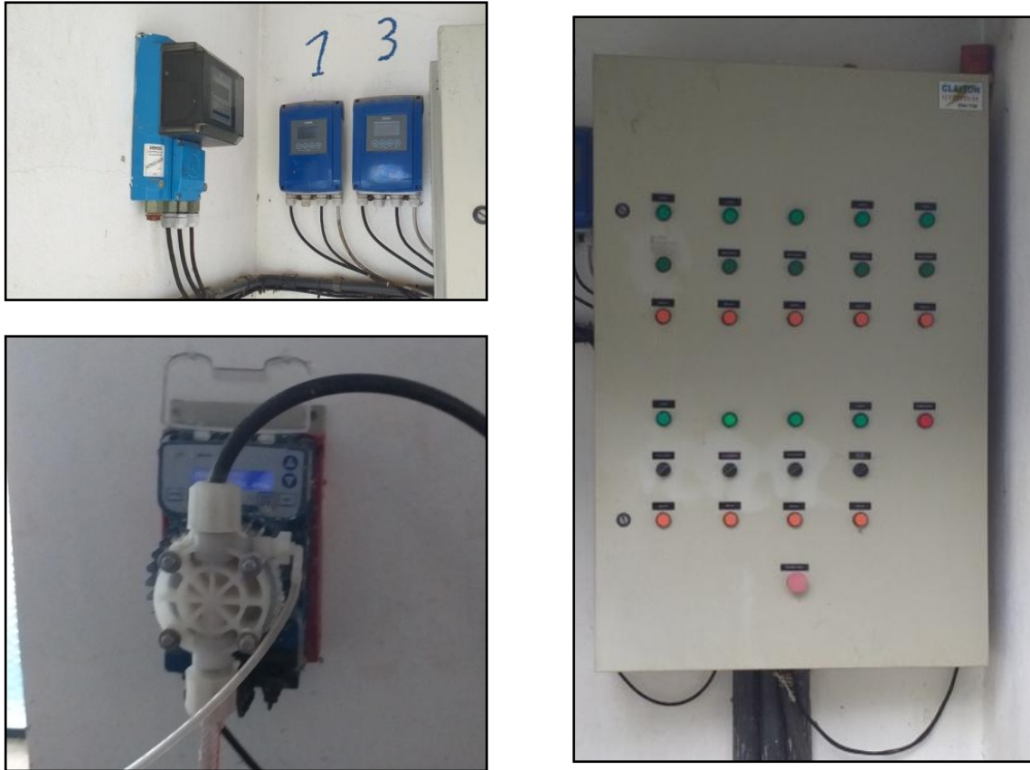
Figura 3.16. Componentes de automação da ETA Bracinho.
