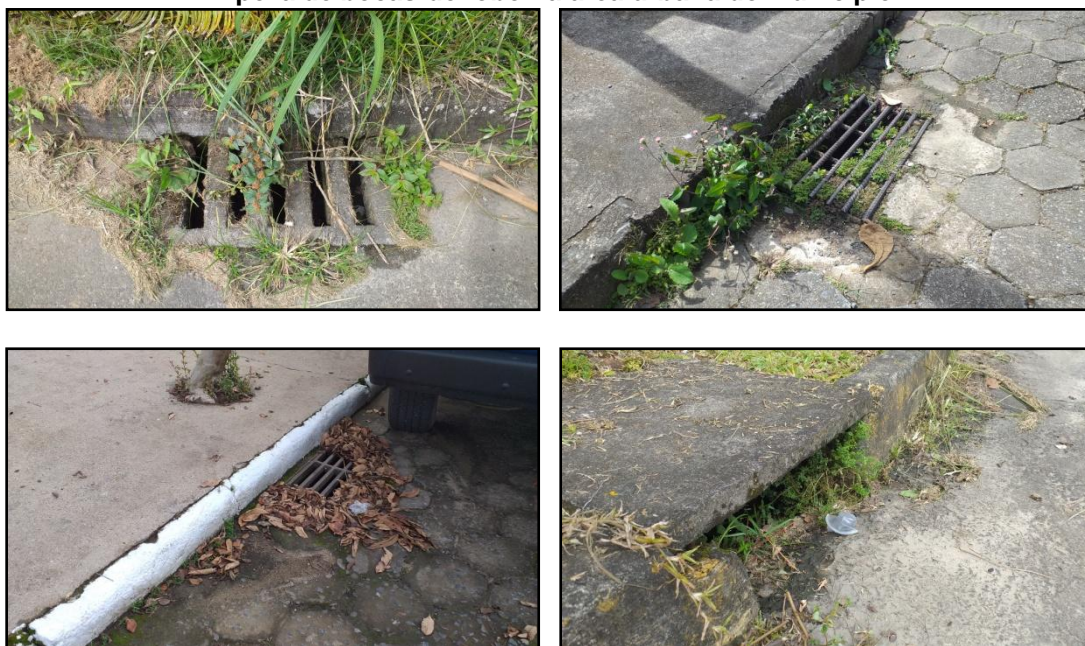
Figura 3.54 – Falta de manutenção dos dispositivos de microdrenagem por serviços de limpeza de bocas-de-lobo na área urbana do município.
