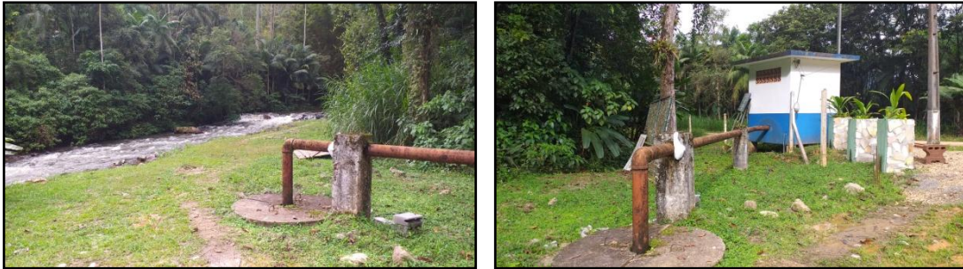
Figura 3.8 – Imagens do sistema de captação e adução do Rio Bracinho.
