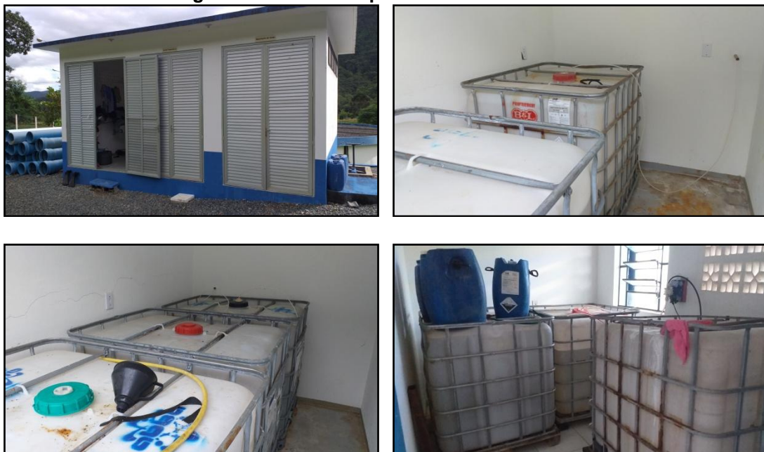
Figura 3.13. Casa de química da ETA Bracinho.
