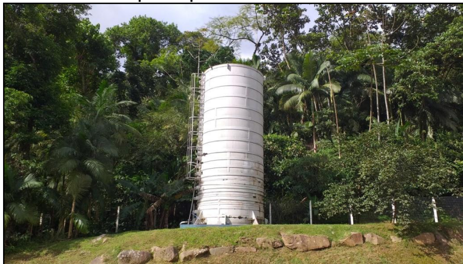
Figura 3.18. Reservatório R1 para limpeza das unidades de tratamento da ETA Bracinho.
