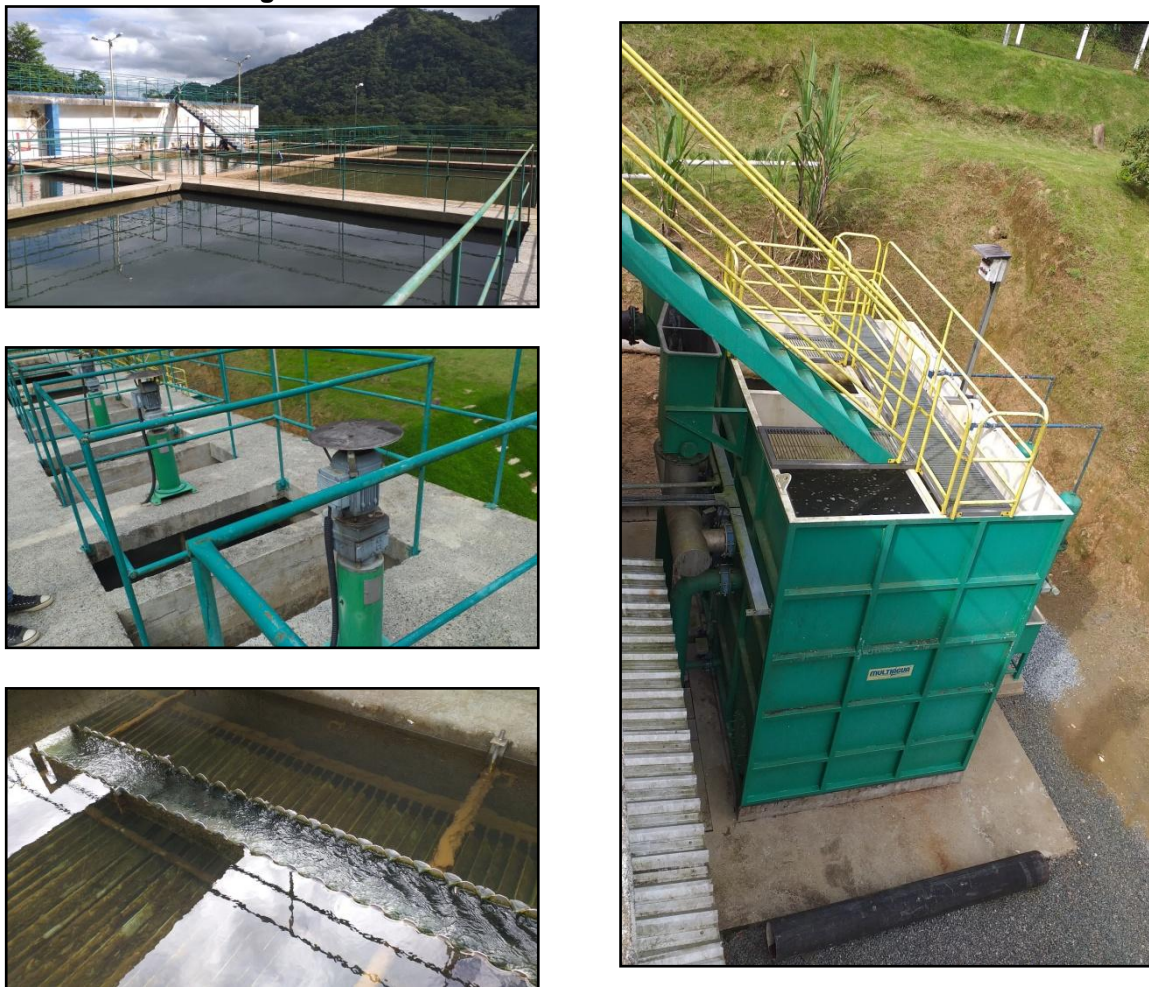
Figura 3.11. Unidades de Tratamento da ETA Bracinho.
