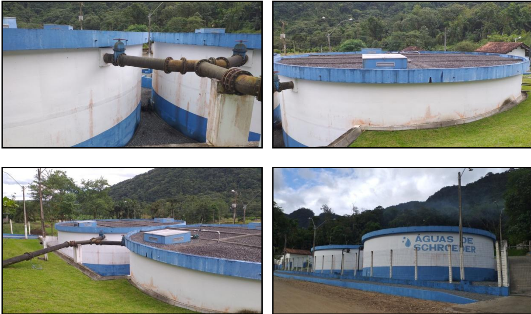
Figura 3.19. Reservatórios R2 e R3 de distribuição de água anexos a ETA Bracinho.
