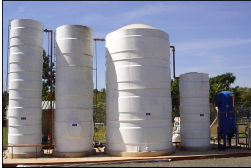
Figura 3.31 - Estação Compacta de Tratamento de Esgotos Sanitários.
