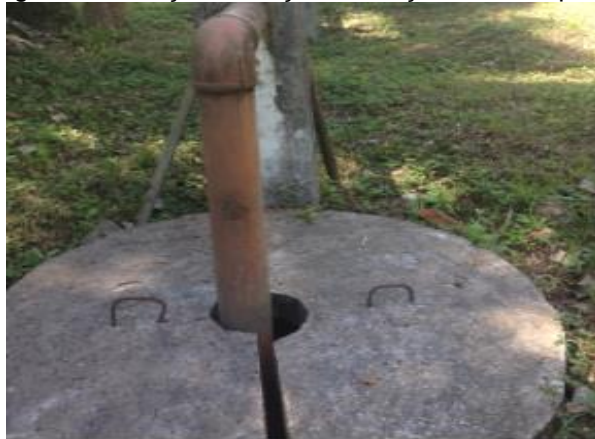
Figura 18 – Poço de sucção e estação de recalque de água bruta
